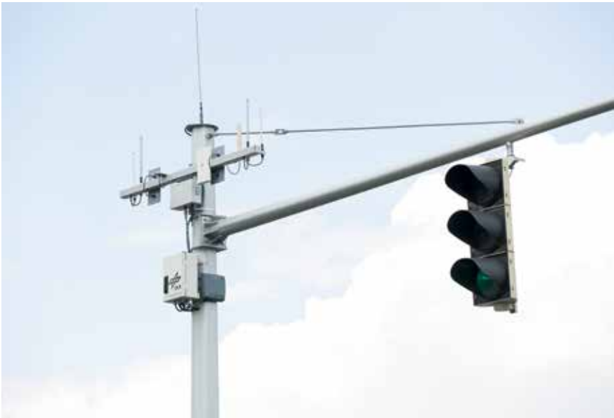
Die Forschungsplattform ist auf dauerhaften Betrieb ausgelegt – und wird als „Labor“ viele Jahre lang unsere Mobilität verbessern helfen. Foto: DLR
