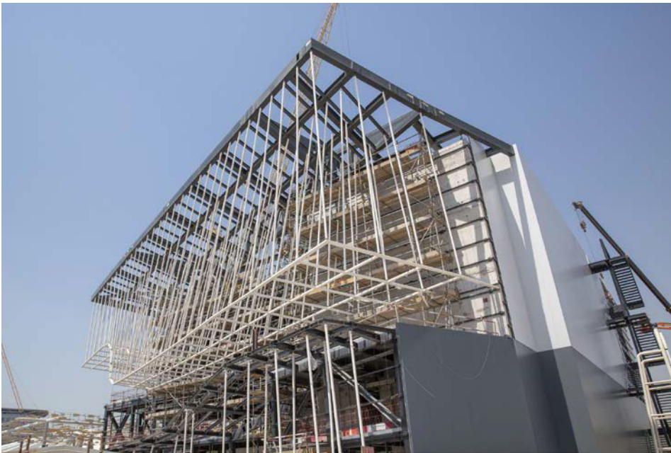
Außenansicht des deutschen Pavillons während der Bau-phase aus der Nähe © Deutscher Pavillon EXPO 2020 / Björn Lauen
