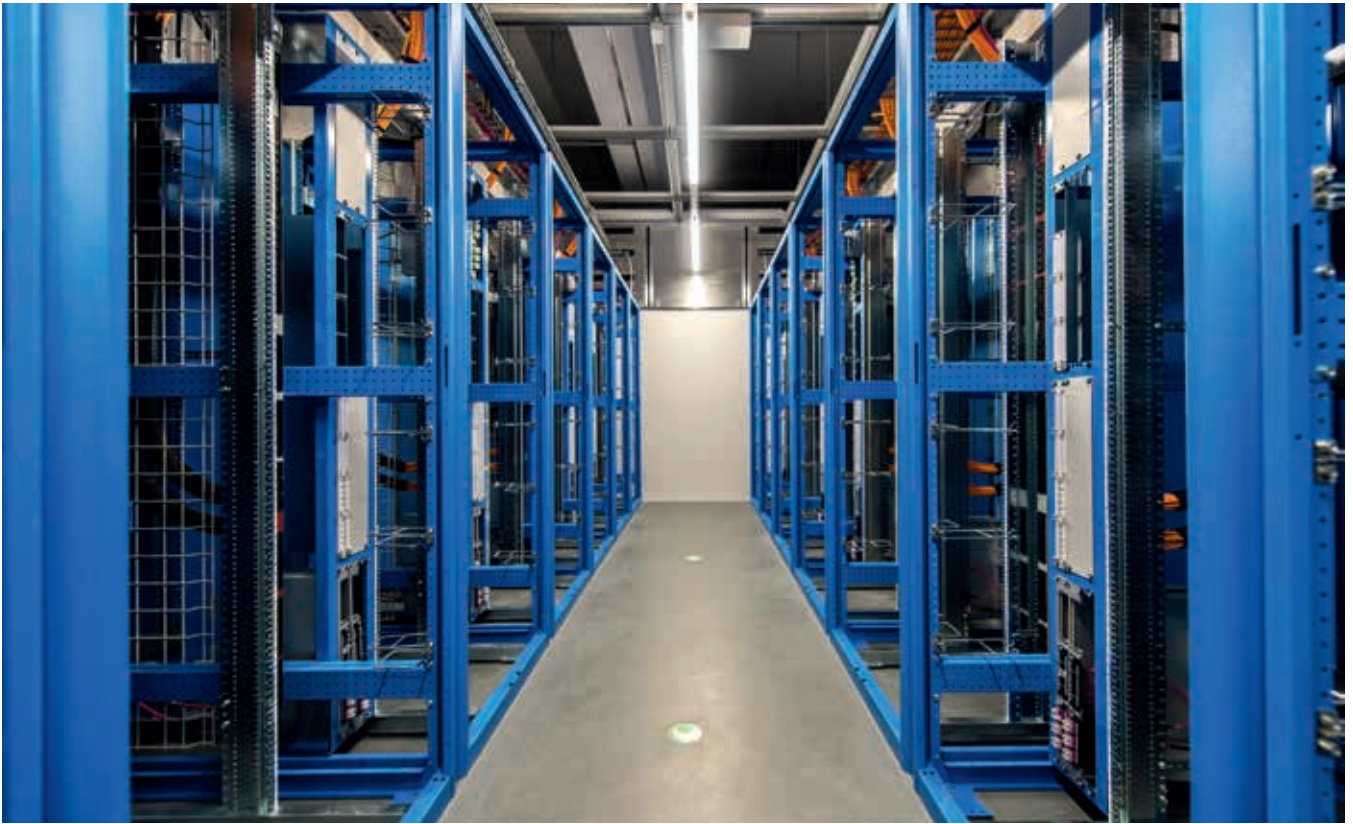
Die Serverräume sind technologisch up to date; Foto: Swisscom
