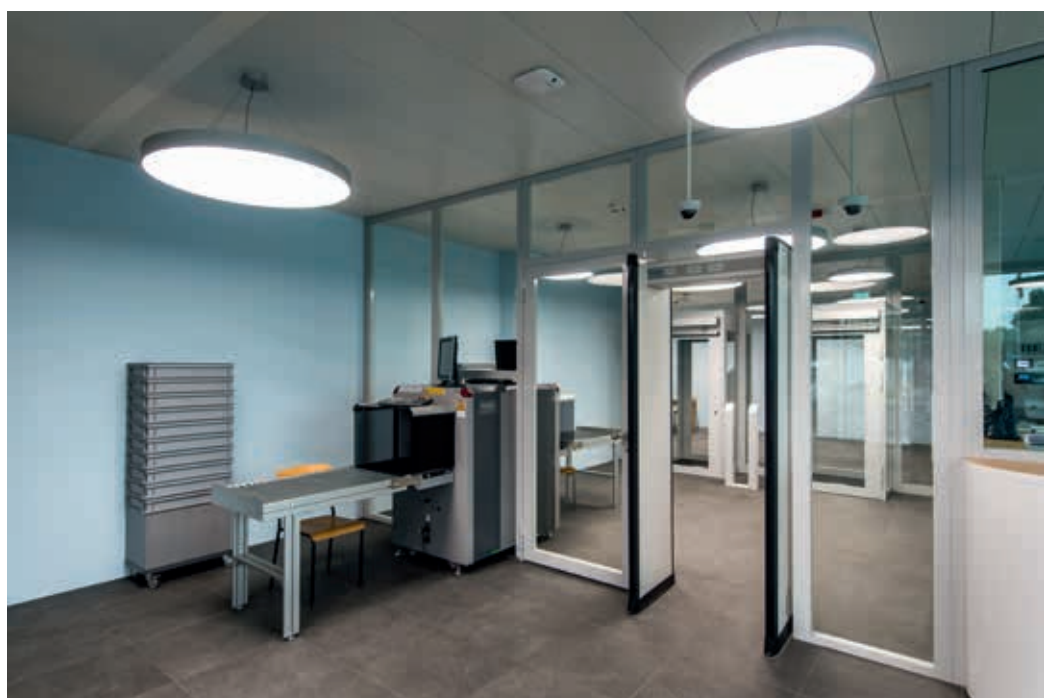
Das Zutrittssystem; Foto: Swisscom
