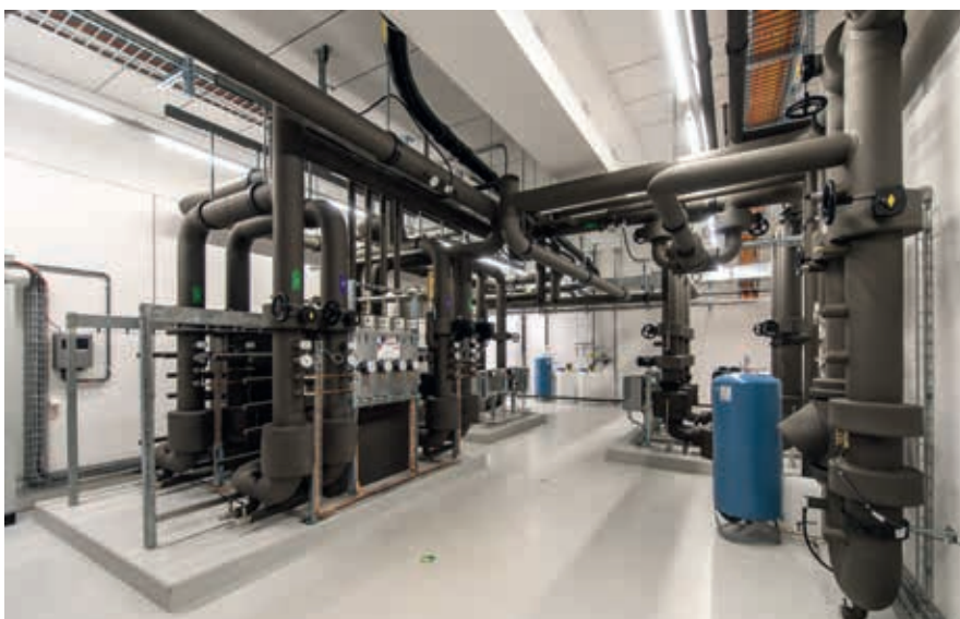
Das „Kühlsystem“; Foto: Swisscom
