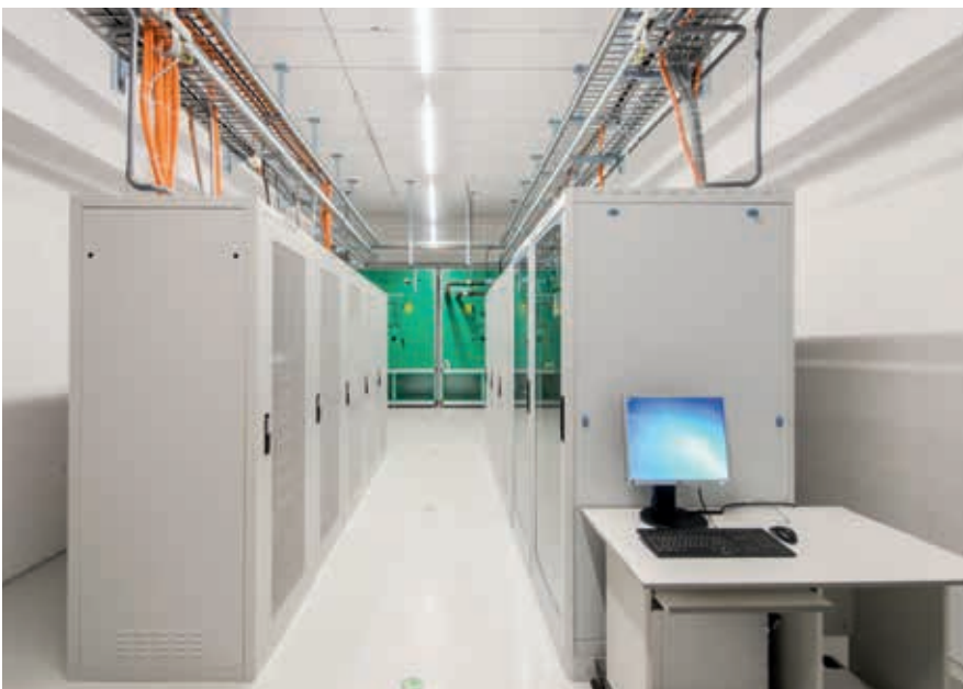
IT-Anlagen in Reih und Glied; Foto: Swisscom
