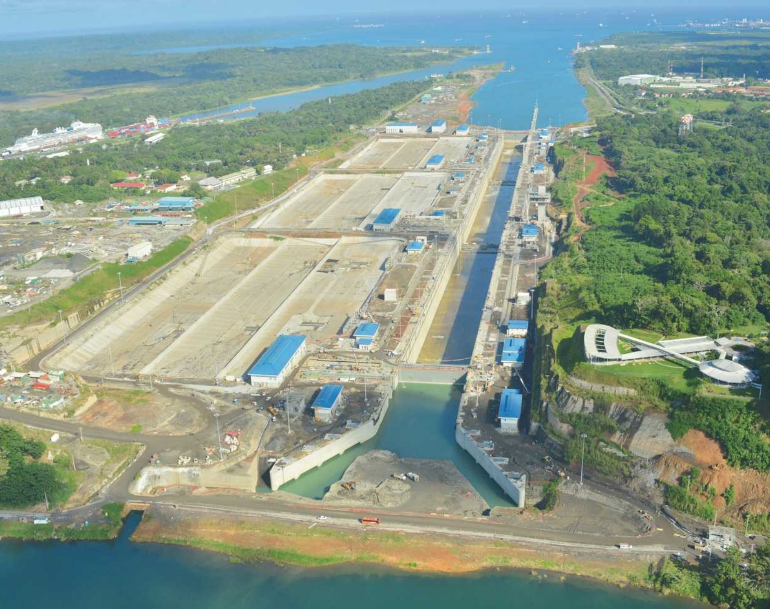
Ein Blick auf die Baustelle: Zu sehen sind die neuen Schleusen auf der Atlantikseite, bereits mit etwas Wasser gefüllt, und die noch trockenen Pufferbecken direkt daneben. Links oben passiert gerade ein Schiff die alten Schleusen. Rechts ist das x-förmige neue Informationszentrum für Besucher zu erkennen. Foto: Panama Canal Authority
